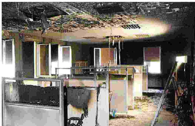
L'interno di alcuni uffici dell'Inps di Modena dopo l'incendio
