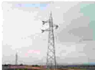
Un traliccio dell'Enel
