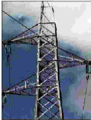
Un traliccio dell'Enel
