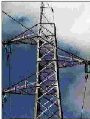
Un traliccio dell'Enel
